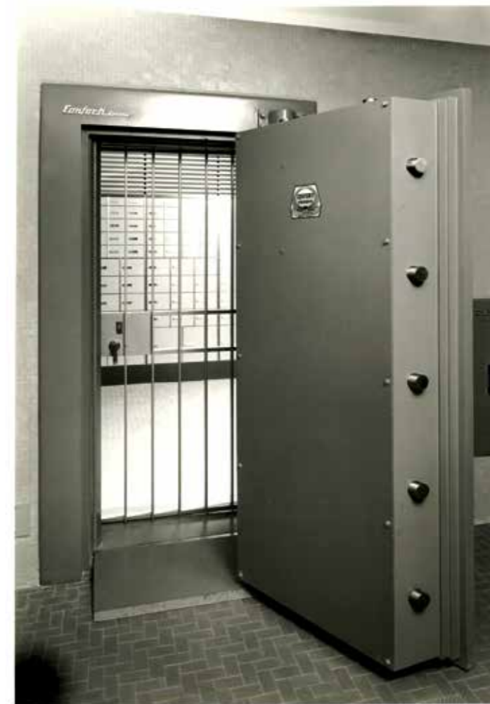
(18) Porta blindata posta all'ingresso del caveau della sede di BPER Banca in via San Carlo 8 a Modena.
